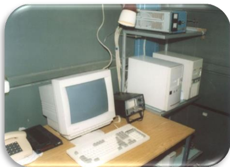
شکل ۲۰: نمایی از کامپیوتر و تجهیزات پردازشگر رادار واقع در اتاقک رادار
