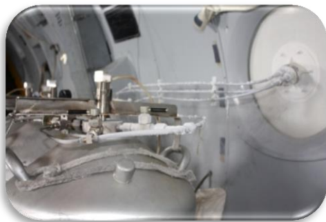
شکل ۱۵: لوله‌های اتصال کپسول‌های حاوی نیتروژن مایع به خروجی
